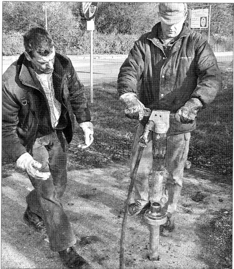
Der Wurzelpfahl – eine Stahlhülse – hilft den Bauhofmitarbeitern beim Schilderaufstellen und dem Kämmerer beim Sparen... SZ-Foto: Markus Dreher
